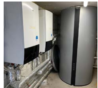
Abb. 68: Zwei Inneneinheiten der Wärmepumpe mit Pufferspeicher
