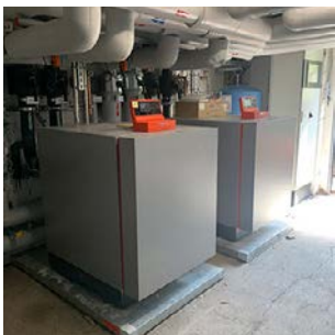
Abb. 52: Wärmepumpen im Keller
