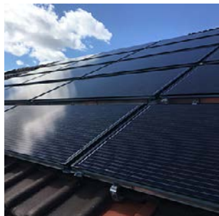
Abb. 58: PVT-Kollektoren auf dem Dach des Gebäudes
