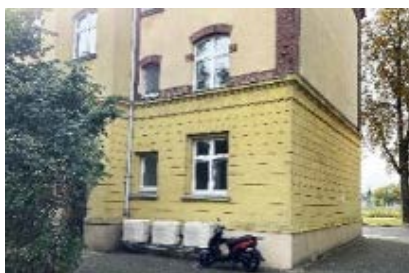
Abb. 42: Installierte Außeneinheiten an Demonstrationsgebäuden
