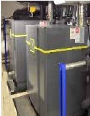
Abb. 44: HT- und NT-Wärmepumpe
